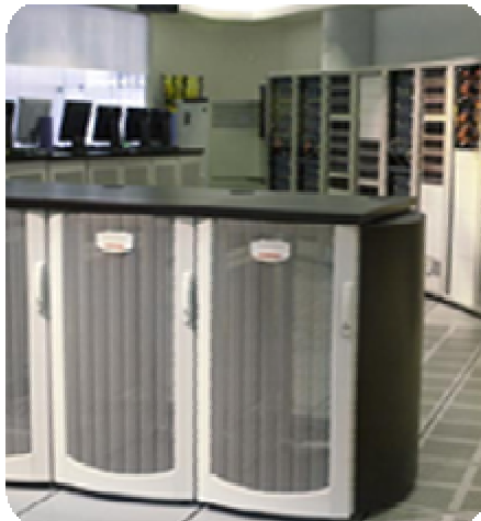
im Data Center
